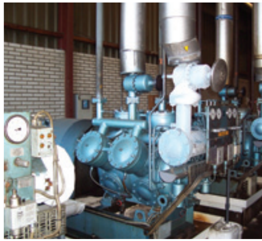
Nach einem äußerst erfolgreichen Testlauf will Kloosterboer im Werk Vlissingen alle Grasso Kühlverdichter auf REFLO 68A umstellen. Die Abbildung oben zeigt einen der Grasso Kühlverdichter im Werk in Vlissingen.
